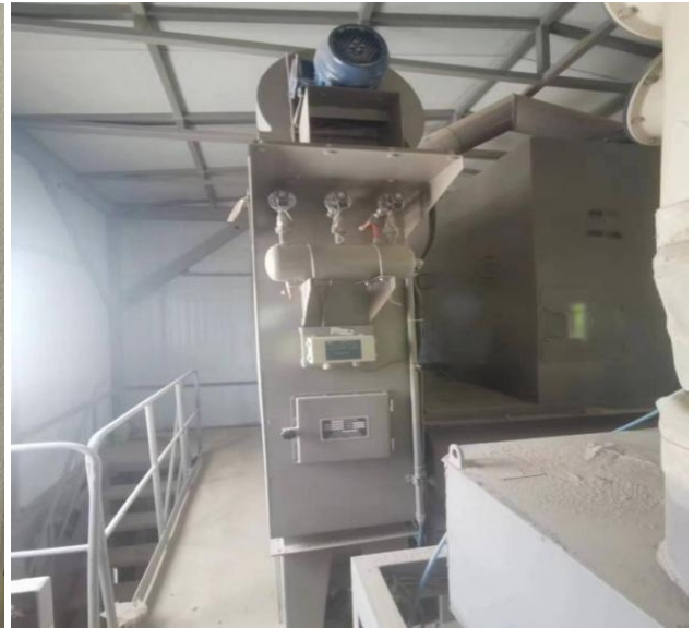
搅拌主机粉尘处理措施
